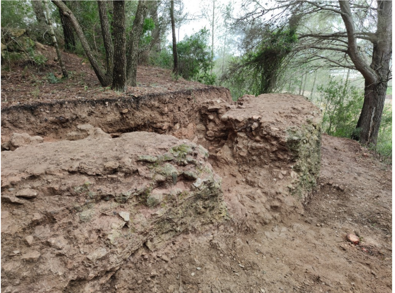
Excavación en el contrafuerte del segundo tramo del acueducto, en el término de Vallmoll (Alt Camp). Foto © ICAC
